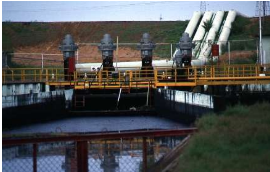
Figuur 2. Elektrisch gemaal en de dijk van Polder Lagunillas, één van de Bolivar Coast Polders
